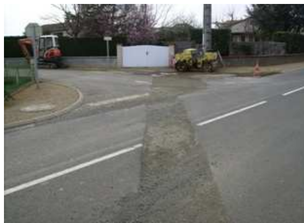
Travaux de mise en place des réseaux d'assainissement et enfouissement des réseaux secs afin de créer le nouveau lotissement privé chemin des Laquais, nommé Dynamo.
